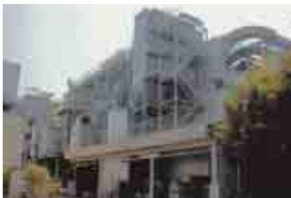
溶解炉用集塵装置
