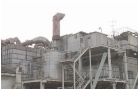
蓄熱式脱臭装置
