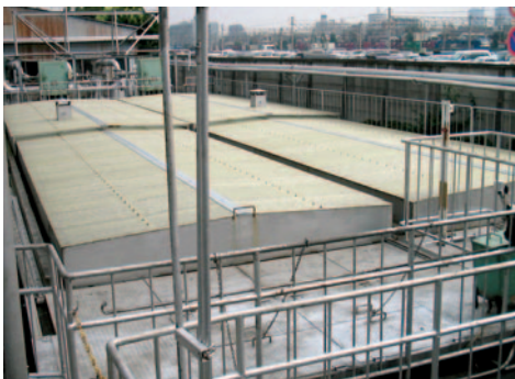
排水処理槽カバー
