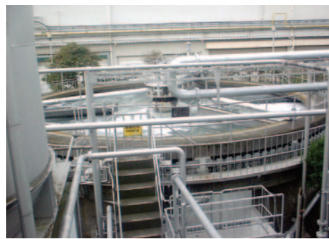
排水処理設備
