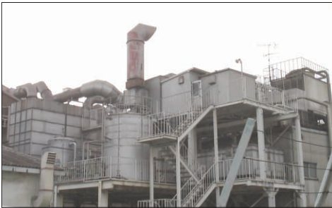
蓄熱式脱臭装置
