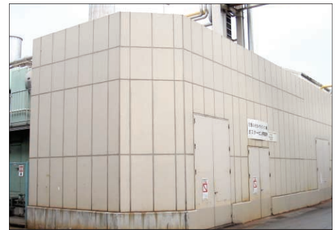
コージェネレーションシステム防音壁
