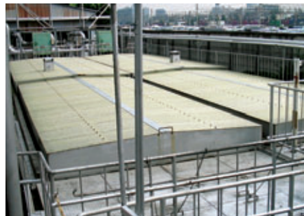
排水処理槽カバー
