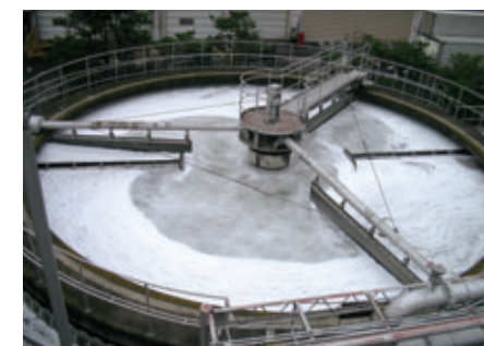
排水処理装置
