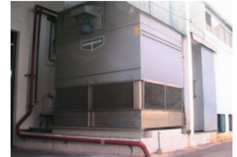
低騒音型冷却設備
