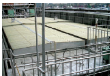
排水処理槽カバー
