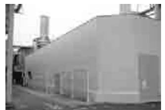
コージェネレーションシステムの防音壁
