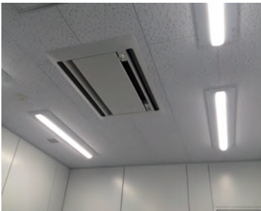
事務所エアコン Office air conditioners
