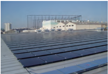
太陽光発電システム Solar power generator system
