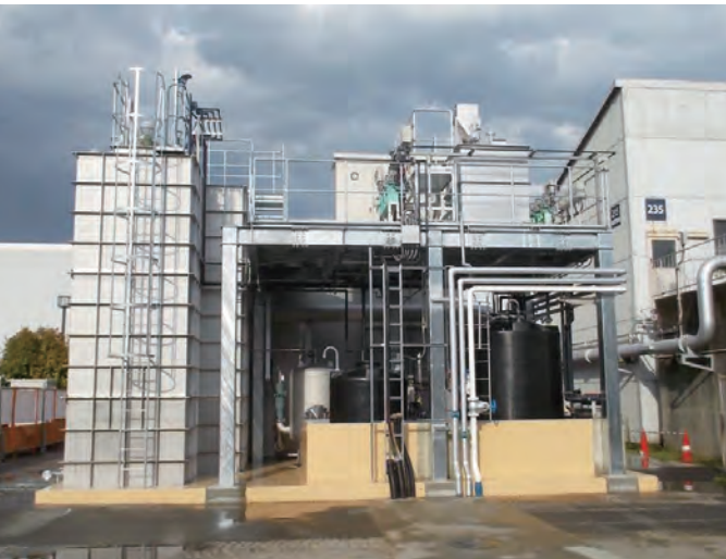
排水処理場のシステム Wastewater processing system
