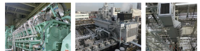
ガスエンジン Gas Engine 新エネルギーセンター New Energy Center セントラル冷暖房システム Central Heating and Cooling System
