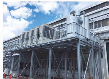
ヒートポンプ
